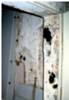
Schimmel-Wasserschaden Quelle: www.enius.de
