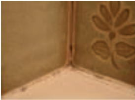
Befall einer Silikonfuge, Quelle: Stadt Oberhausen
