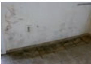
Schimmelpilzbefall einer Aussenwand Quelle: Stadt Oberhausen
